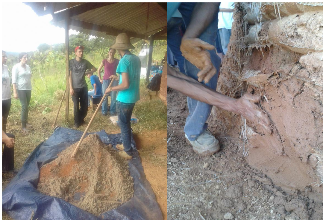
Figura 3 - Curso de Bioconstrução – Reboco de Super Adobe. Preparação e uso. (Autor: Mônica Hashimoto, 2017)
