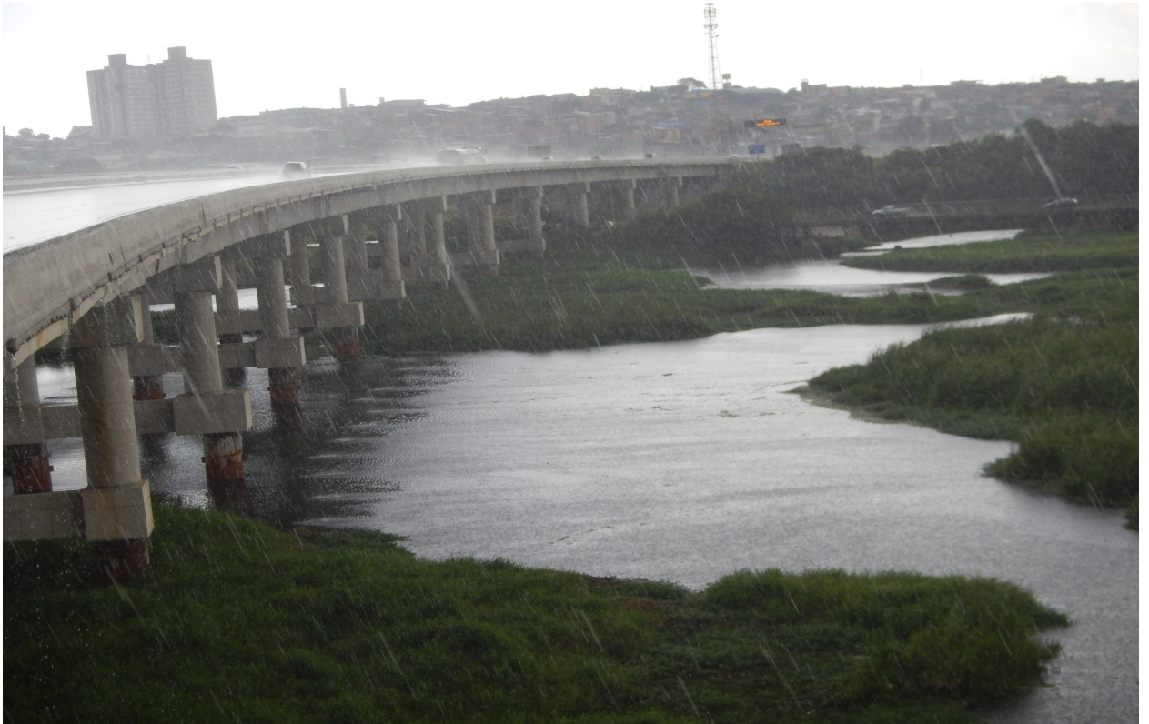
Figura 11 - Trecho da rodovia próximo a um meandro do Rio Tietê, destaque para a estrutura colunar apresentada pelo empreendimento. Fotografia: Marcelo Hideki Yamane. Data: 05/02/2016.
