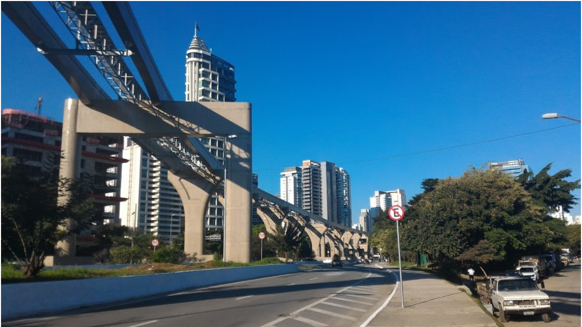
Figura 1 – A construção do Monotrilho nas proximidades da construção da Estação Chucri Zaidan. Fonte: autora, junho de 2017.
