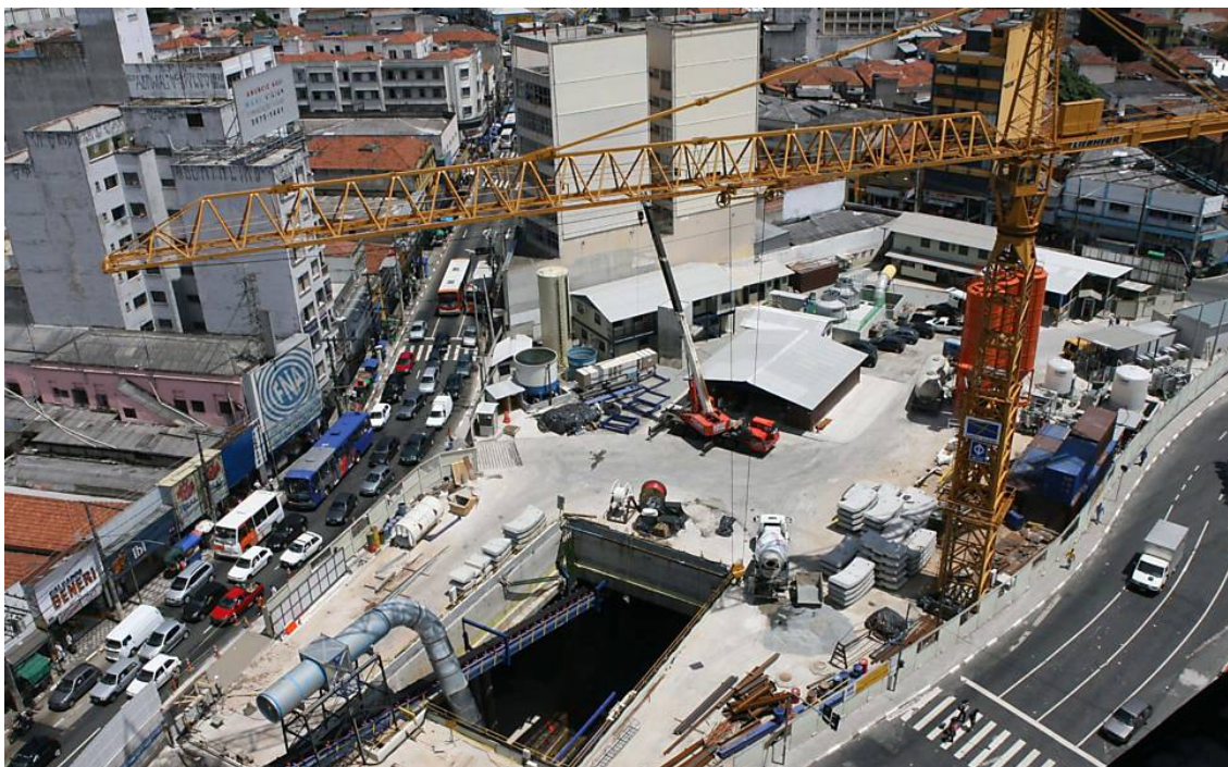
Foto aérea do Largo da Batata, do canteiro de obras da estação de metrô Faria Lima (2007). A estação foi construída exatamente sobre o antigo Largo da Batata, nome que se remete à antecedente função de entreposto agrícola, no começo do século XX, agora suprimido e substituído pelo nome de Estação Faria Lima.
