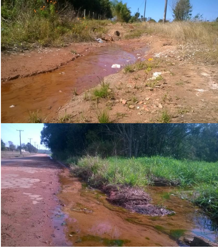
Figura 26: Acima, curso d'água que passa sobre a Avenida Rio Piouri sem nenhuma adequação, e abaixo, curso d'água desviado sobre a Avenida Parque dos Lagos. Retirada em 19 de julho de 2016. Autora: Natalí de Gregorio.
