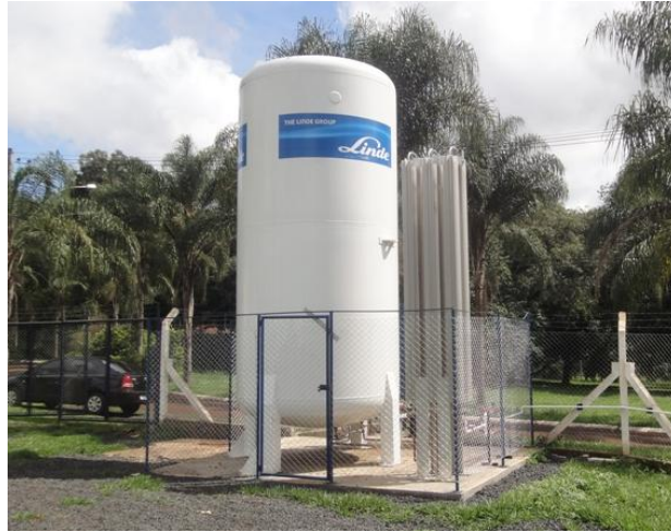
Figura 5. Tanque de CO 2 com capacidade para 12 toneladas e sua unidade vaporizadora, à direita.
