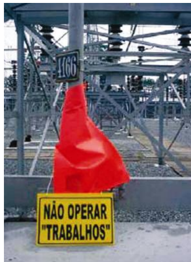
Figura 11 - Exemplo de sinalização de impedimento de energização
