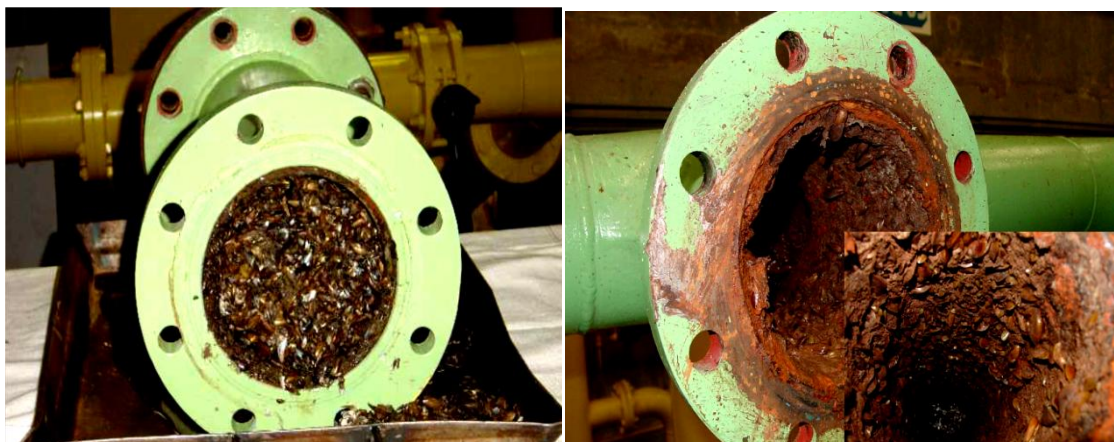
Figura 10 - Entupimento e obstrução de dutos por mexilhões. Note também que estes mexilhões propiciam a oxidação de tubulações, como visto à direita.
