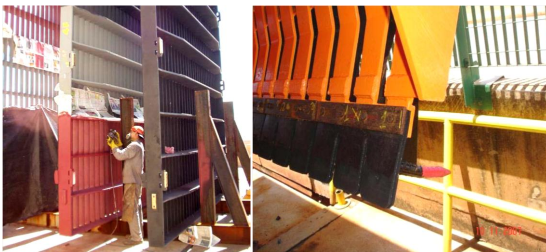
Figura 12 - À esquerda, operador aplicando tinta para minimizar a fixação de mexilhões em grade de UHE. À direita, adaptação de palhetas de borracha nas pontas de limpador de grade a fim de remover mexilhões incrustados.
