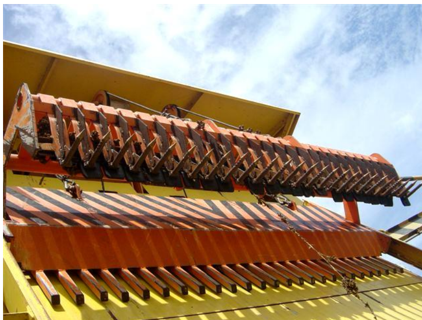
Figura 29 - Sistema de Limpeza da UHE de Porto Primavera.
