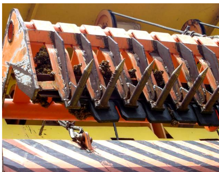
Figura 31 - Detalhe das palhetas de borracha adaptadas à caçamba (rastelo) do Sistema de Limpeza da UHE de Porto Primavera.
