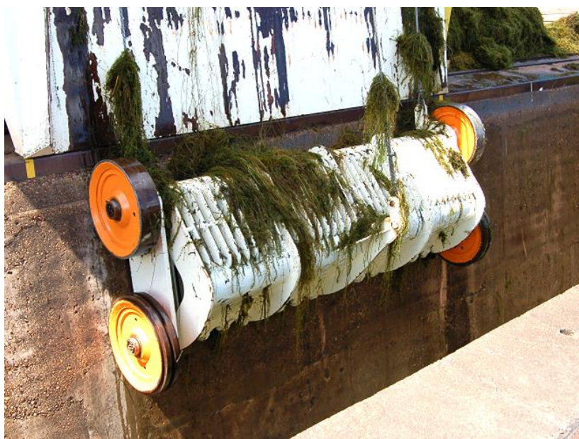
Figura 30 - Sistema de Limpeza atualmente utilizado em Jupia.
