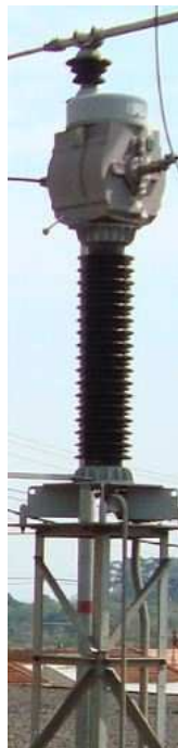
Figura 10: TC de subestação de 138kV em funcionamento.
