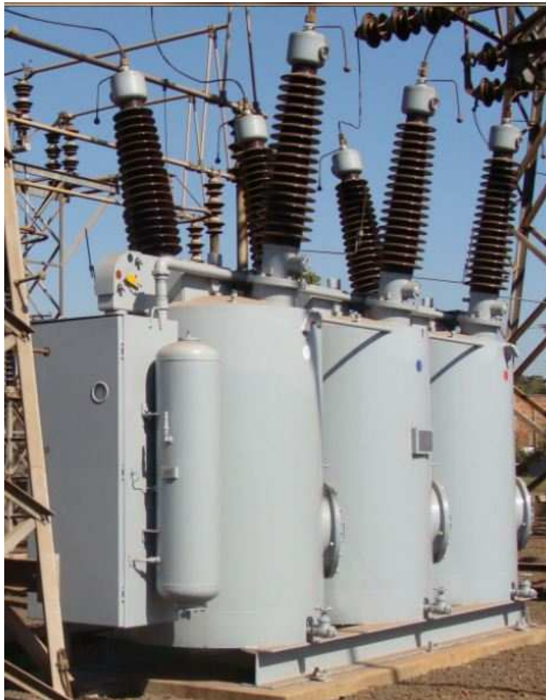
Figura 13: Disjuntor tripolar a grande volume de óleo de SE de 138kV.
