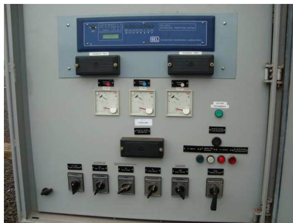
Figura 12: Painel de proteção de SE de 138kV.
