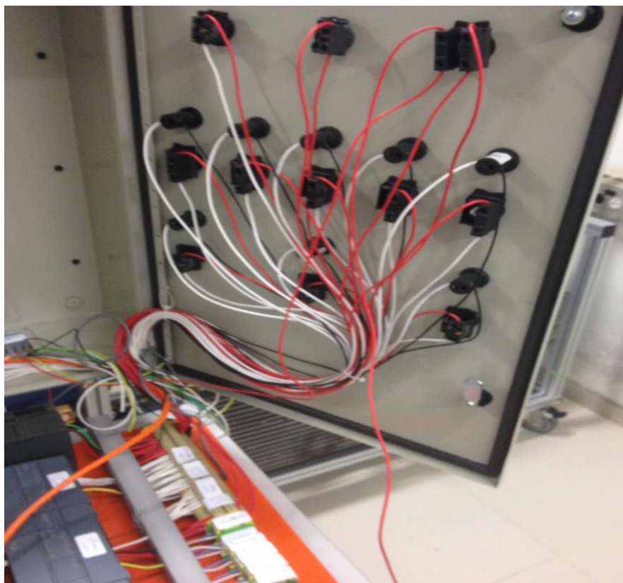
Figura 14 - Painel elétrico desmontado
