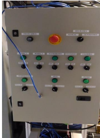
Figura 10 - Painel com display de temperatura, chaves, botão, sinais luminosos, entrada de cabo de rede ethernet e chave geral
