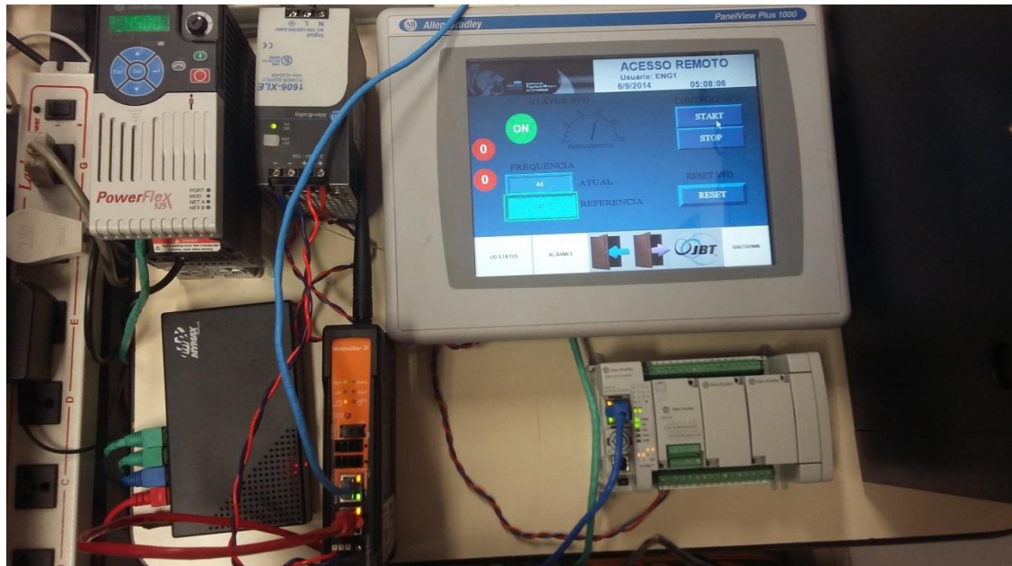
FIGURA 52: Montagem do sistema como Router Weidmuller.
