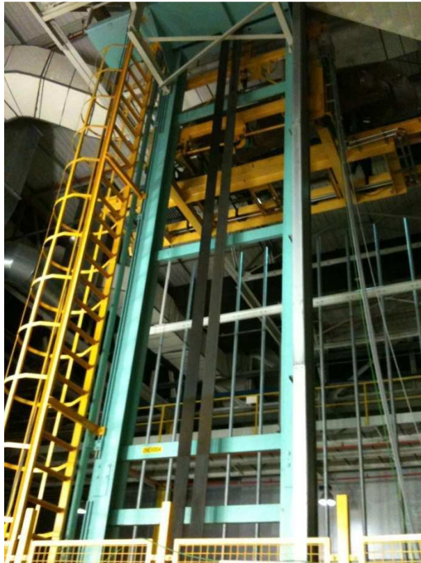
Figura 40 - Vista do sistema de fixação de segurança do elevador
