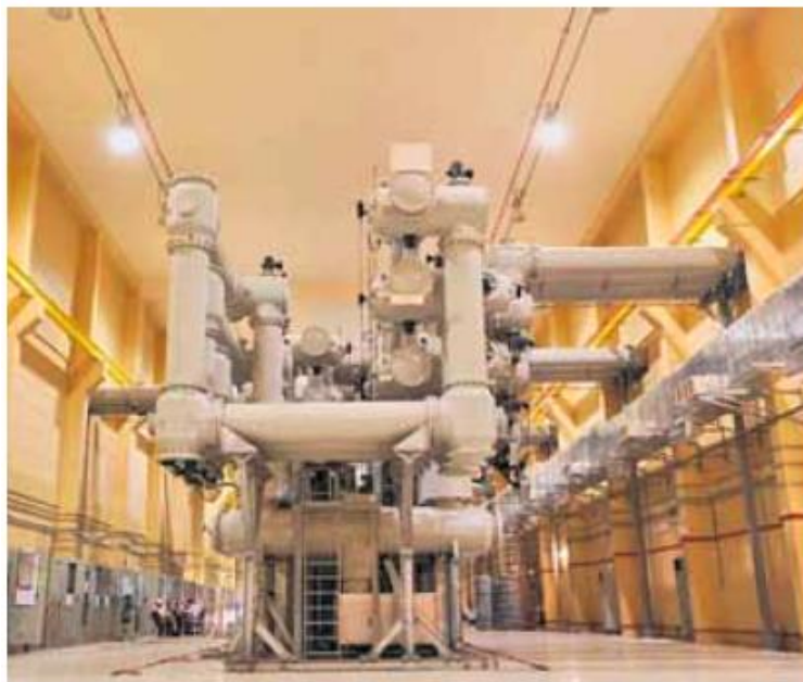
Figura 2.7: Exemplo de subestação blindada isolada a SF 6 , as chamadas GIS – Gas Insulated Switchgear
