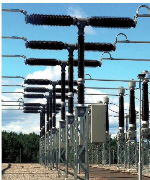
Figura 2.10: Exemplo de disjuntores tripolar de alta-tensão (400 kV).
