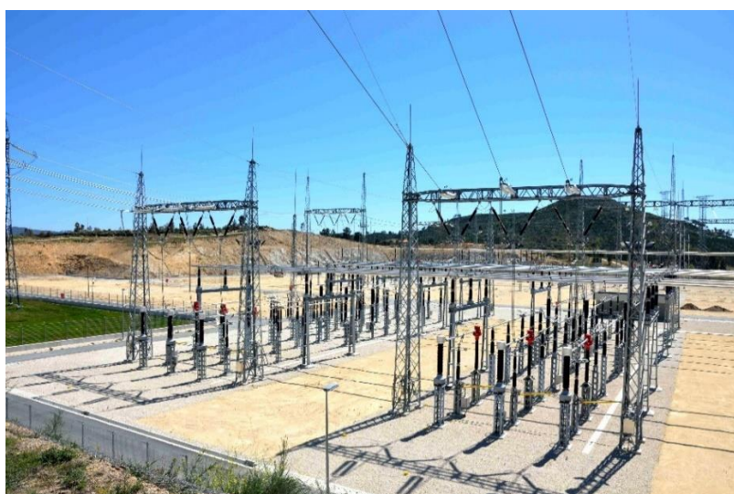
Figura 2.6: Exemplo típico de subestação desabrigada AIS – Air Insulated Switchgear .
