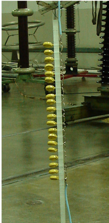
Figura 20 - Divisor capacitivo com capacitores alinhados paralelamente
