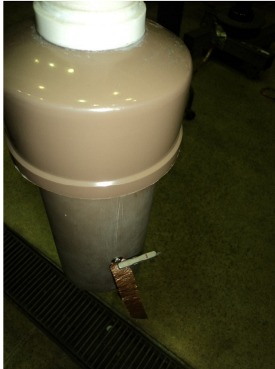
Figura 32 - Aterramento do divisor feito pelo prensa cabo conectado ao invólucro
