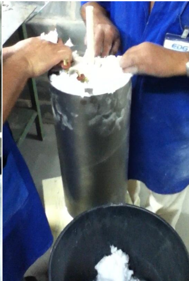
Figura 10 - Construção do forno: preenchimento com material refratário para isolamento de temperatura interna para o exterior
