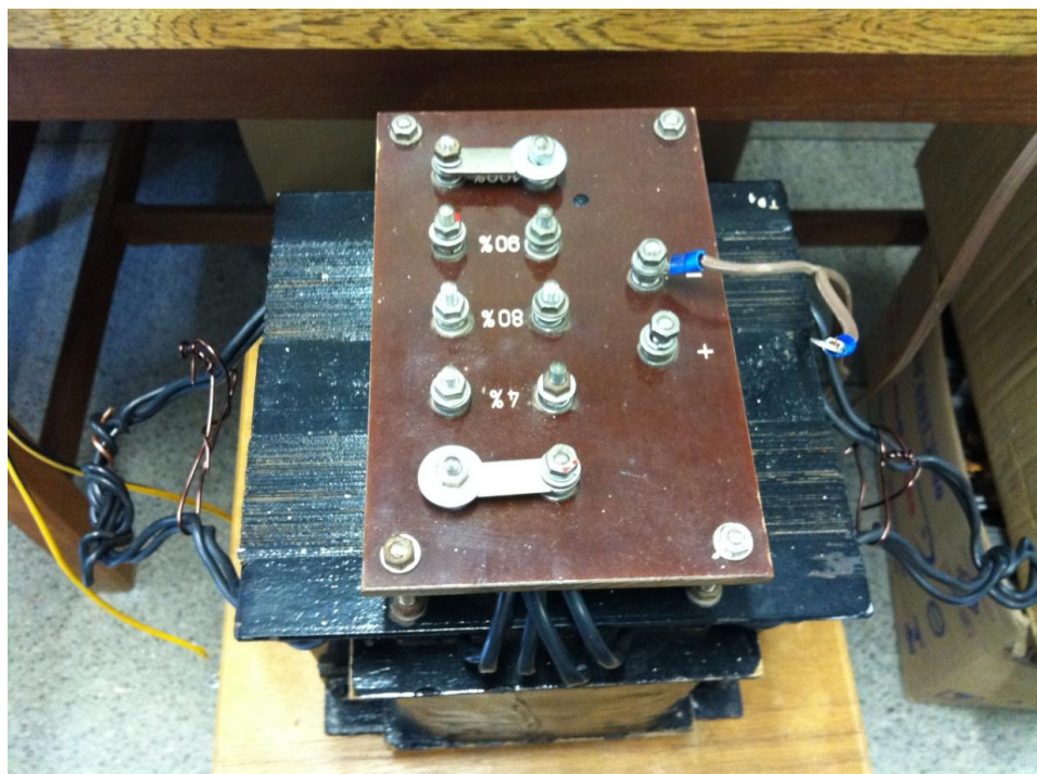
Figura 7 - Transformador utilizado no projeto com relação de tensão 3,6:1
