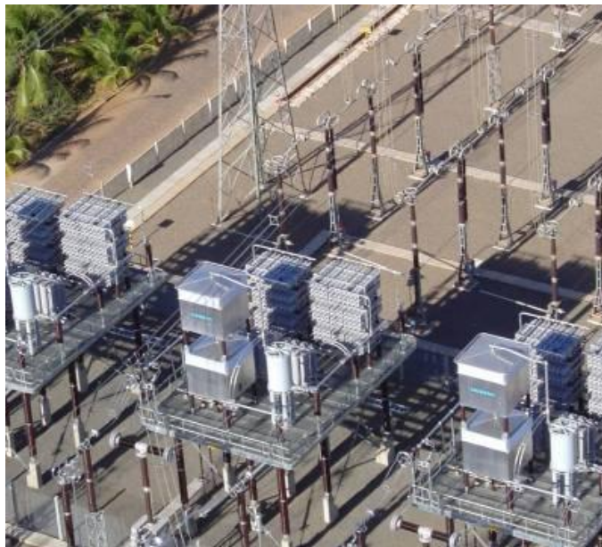
Figura 51 - Banco de capacitores em série sobre plataforma [46]
