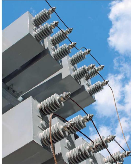
Figura 45 - Banco de capacitores [42]
