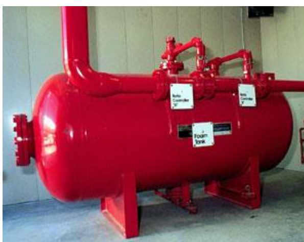
Figura 76 - Tanque de armazenamento de pré-mistura para espuma [68]
