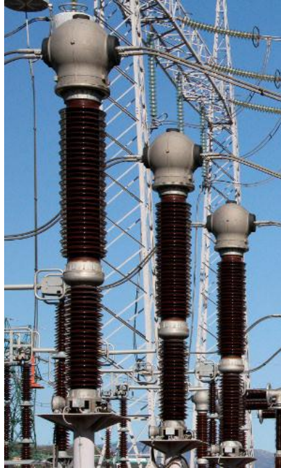
Figura 34 - Transformadores de corrente [29]
