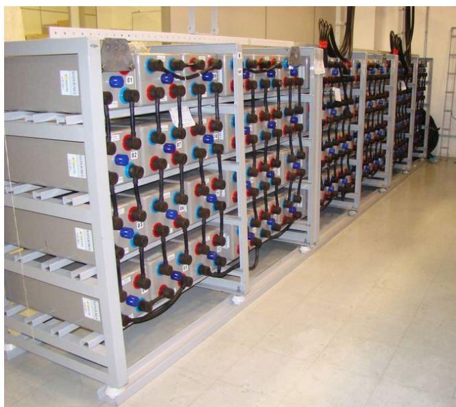
Figura 62 - Banco de baterias [54]
