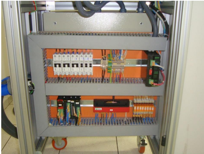
Figura 11: Armário elétrico traseiro.
