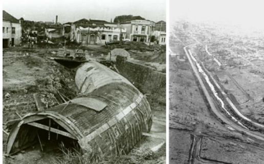
Figura 5.2 – À esquerda: obra de canalização e tamponamento do córrego do Gregório, na década de 1970, num trecho em frente ao Mercado Municipal. À direita: execução das vias marginais em 1974.
