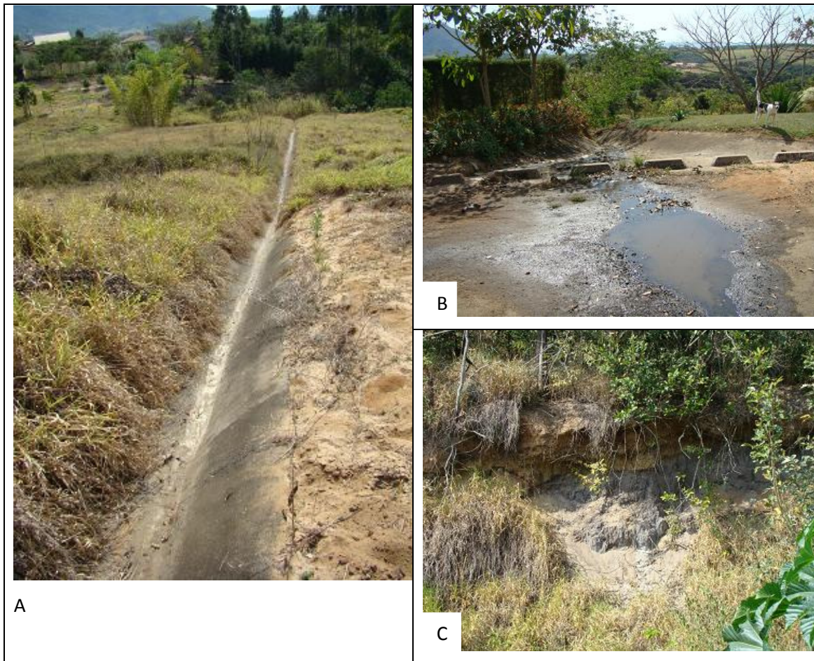
Figura 64: Canal que direciona a água de escoamento (A); entrada do canal (B); erosão a jusante do canal (C) – Julho de 2008
