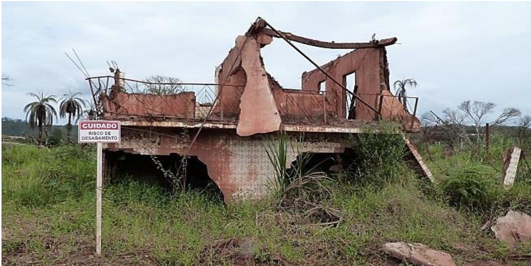
Fotografia 01 - Ruínas da Associação de Moradores do Distrito de Bento Rodrigues, totalmente destruída após a passagem da lama em novembro de 2015. Fonte: (Alunos do curso de Engenharia Ambiental/USP, 2016).
