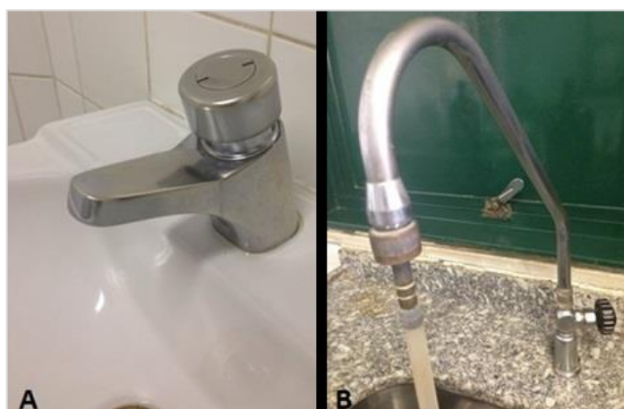
Figura 4. Torneiras utilizadas na EPP: A) Banheiros e B) Laboratórios.
