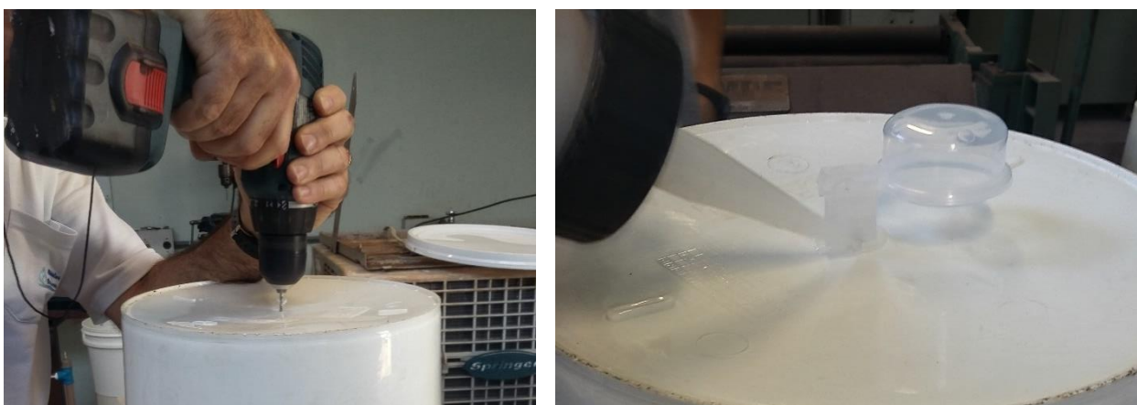
Figura 22. Colocação da boia do filtro intermitente. (1) Detalhe do uso da furadeira. (2) Detalhe da aplicação de silicone.
