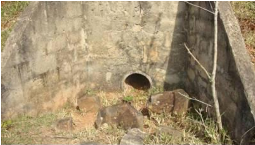
Figura 47: Blocos de rocha dispostos na frente de uma saída de tubulação funcionando como um dissipador de energia tipo bacia de impacto (ROTTA, 2012).
