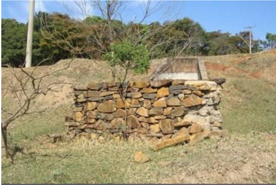
Figura 48: Muro de contenção posicionado na frente de uma saída de tubulação funcionando como um dissipador de energia tipo bacia de impacto (ROTTA, 2012).
