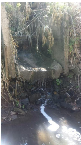
Figura 27. Canalização de esgotamento doméstico e drenagem urbano/viária no médio curso do Tijuco Preto (Agosto/2016)
