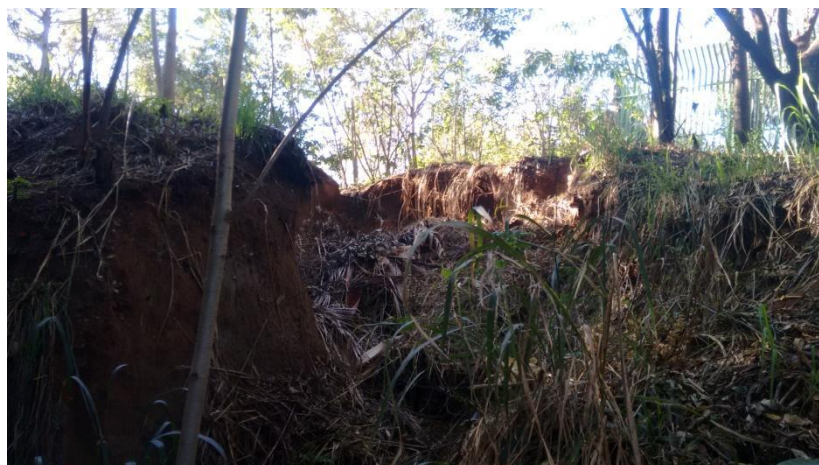
Figura 20. Processo erosivo avançado na nascente do córrego Tijuco Preto (Agosto/2016)
