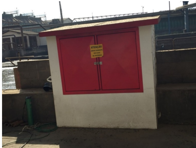
Figura 10: Abrigo em alvenaria para mangueiras de incêndio.
