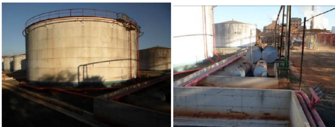
Figura 13: Montagem das linhas para espuma mecânica para alimentação das câmaras de espuma.
