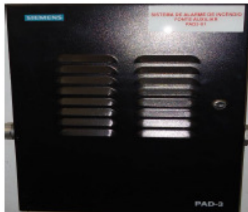
Figura 17: Fonte Auxiliar do Sistema de Alarmes.
