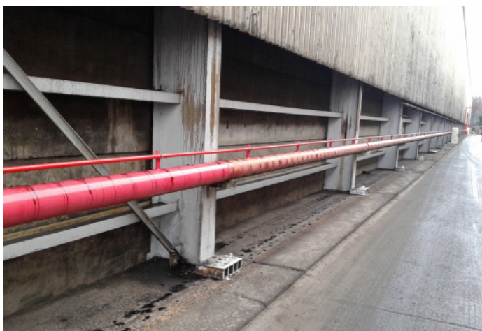
Figura 9: Tubulação utilizada no sistema de hidrante.
