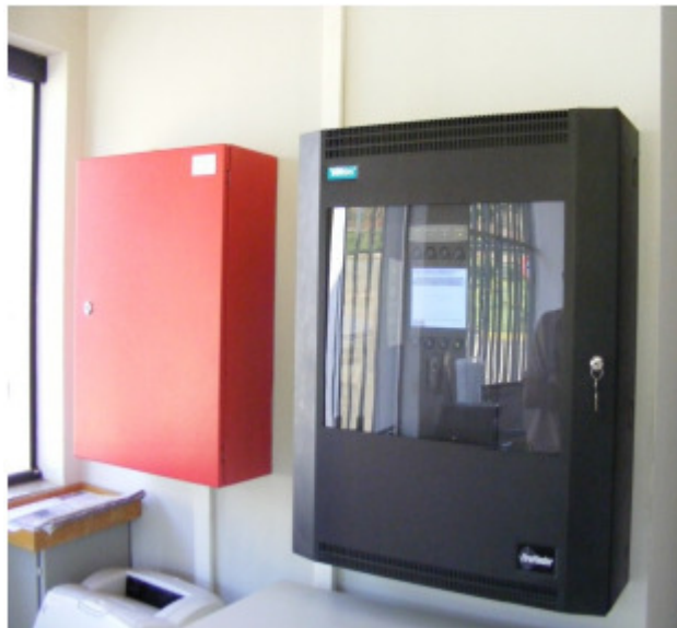
Figura 18: Central do Sistema de Alarme.
