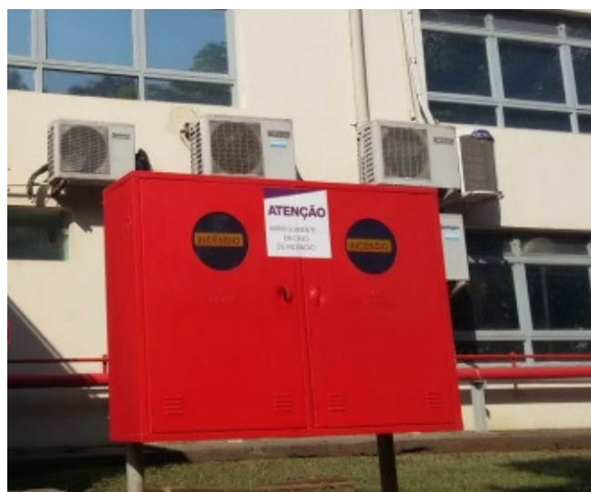
Figura 11: Abrigo metálico para mangueiras de incêndio.
