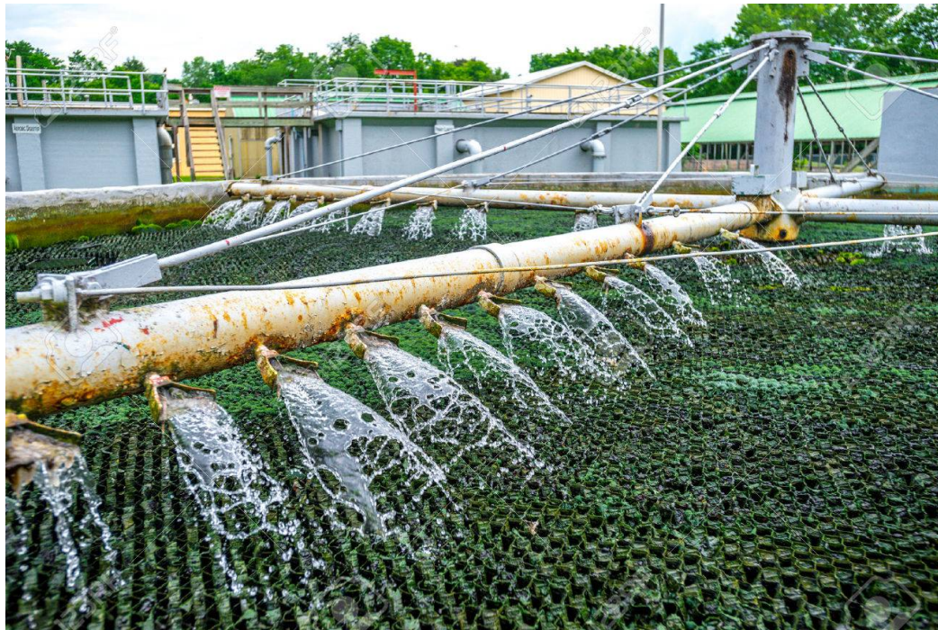
Figura 10 - Fotografía de un filtro biológico percolador
